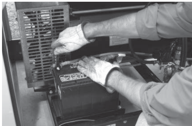
Рисунок 1.15. Проверка клеммных соединений
