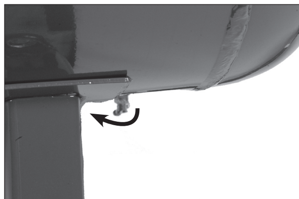
Figure 16 - Drenaje manual del tanque
