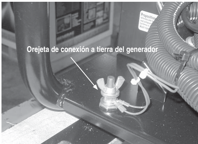
Figura 13 - Conexión a tierra del generador
